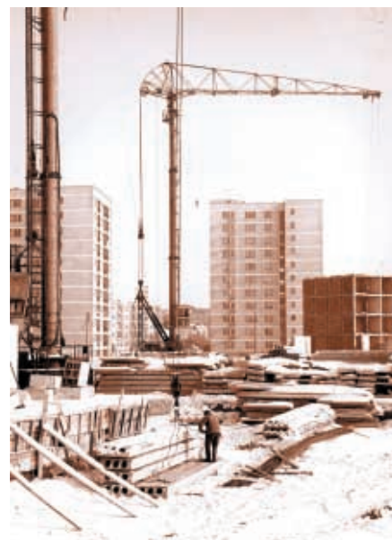
Grudzień 1971 r. – budowa wieżowca przy ul. Chopina 15. Kto wtedy myślał o podzielnikach?
