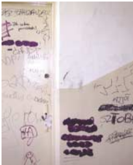
Tak zniszczyli wandale klatkę schodową w budynku przy ul. Karłowicza 13
