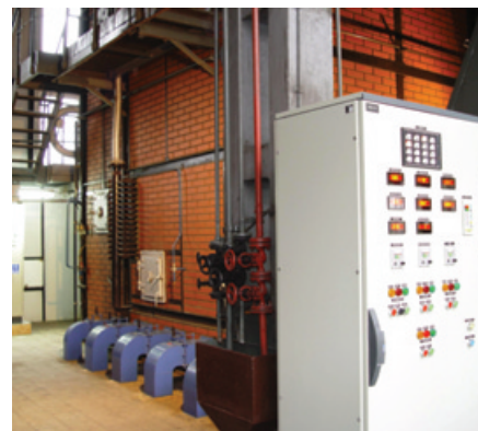
Nowoczesna wyposażenie kotłowni
