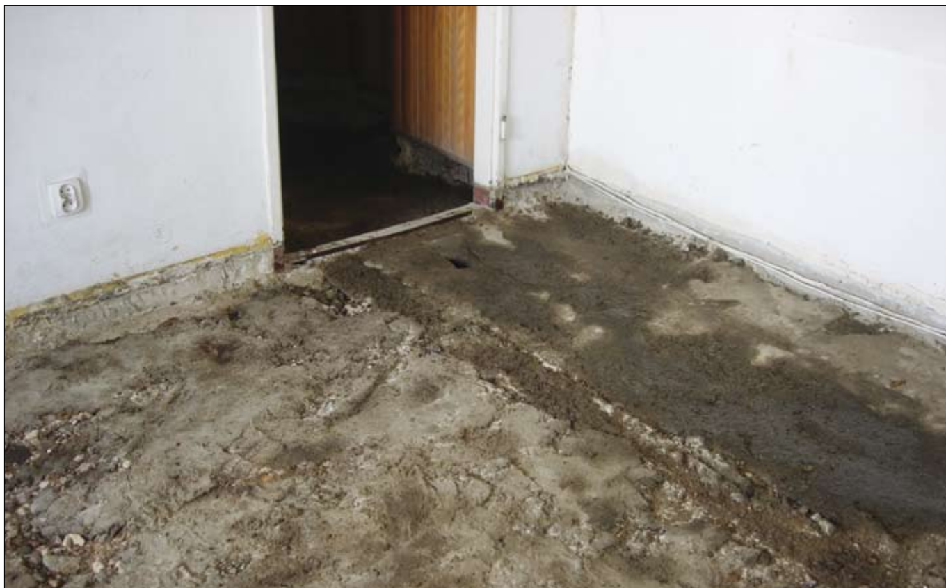
Warstwa ksylamitu, po zerwaniu podłoża
